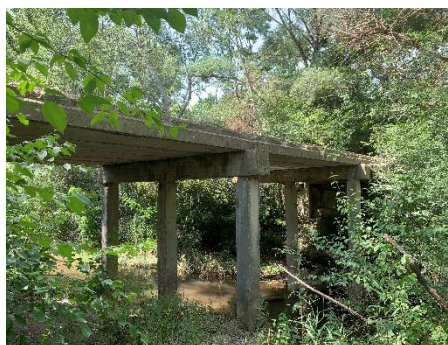
Рис. 8. Железобетонный мост без ограждений Fig. 8. Reinforced concrete bridge without fences
