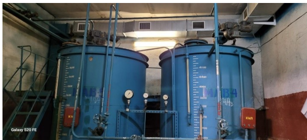
Рис. 1. Аммиачное хозяйство с устаревшей вытяжной системой вентиляции.
