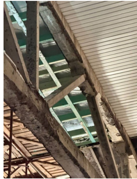
Фото 2. Состояние ж/б стропильных ферм после пожара Photo 2. Condition of reinforced concrete roof trusses after the fire
