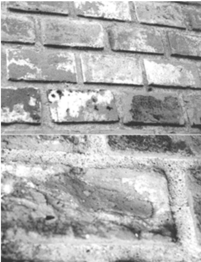
Рис. 2. Примеры разрушительного воздействия растворимых солей на кирпичную стену.
