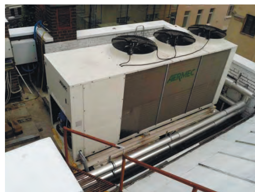
Рис. 7. Установленный на крыше чиллер
