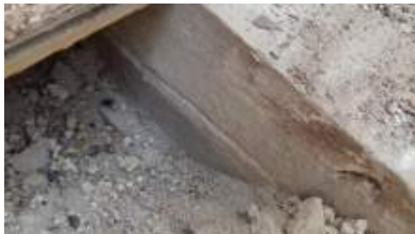
Рис. 4 – Продольные трещины деревянной балки.
