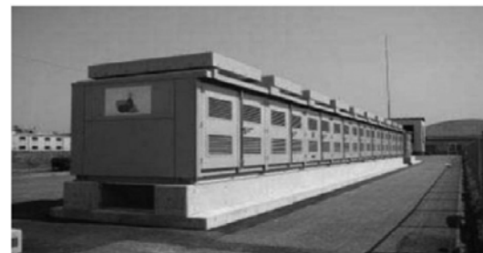
Рис. 14. Фото буферного НЭ для ВЭС на острове Хоккайдо мощностью 34 МВт
