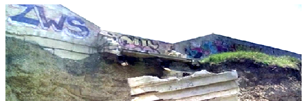
Рис. 5. Общий вид бетонного ограждения со стороны моря у пансионата «ВОЛНА» Аварийное состояние грунтов основания и фундаментов
