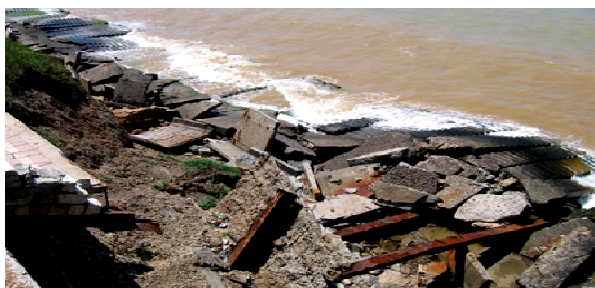
Рис. 6. Разрушение грунтового основания лестничного сооружения у пансионата «ВОЛНА»
