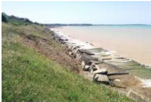
Рис. 2. Разрушенные конструкции откосных сооружений и набережной с. Песчаное
