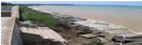
Рис. 7. Обрушившиеся конструктивные элементы средней и нижней частей сооружения у пансионата «ВОЛНА» с. Песчаное
