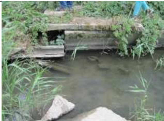
Рис. 6. Разрушенные береговые укрепления
