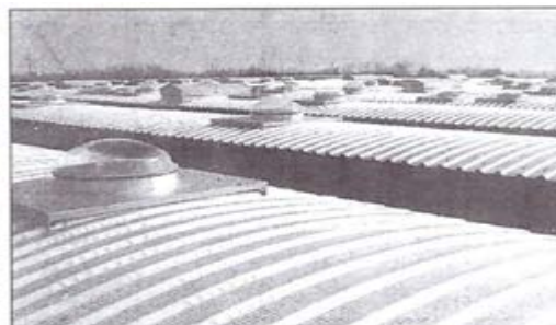
Рис. 6. Световоды на крыше склада Fig. 6. Light guides on the roof of the warehouse
