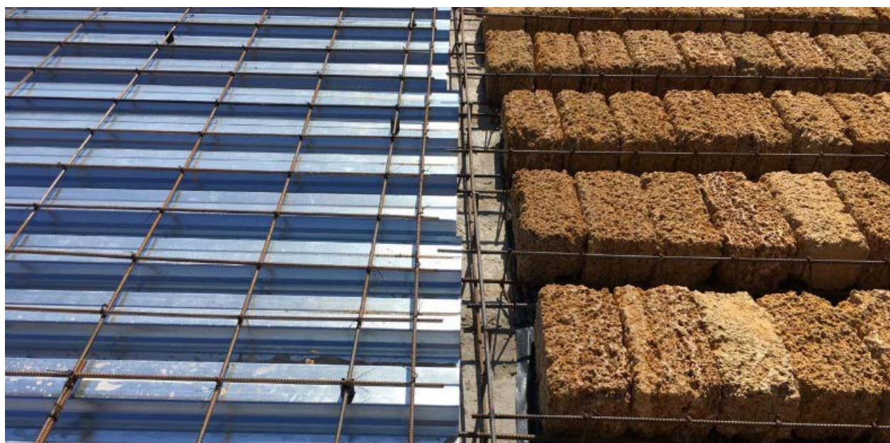
Рис. 1. Общий вид подготовленных к бетонированию перекрытий: по стальному профилированному настилу (слева) и с блоками-кладушками известняка-ракушечника (справа)
