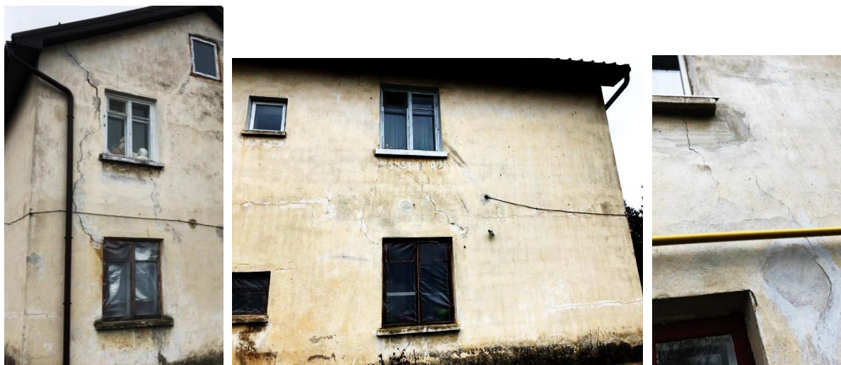
Рис. 1. Характерные трещины в стенах зданий Fig. 1. Characteristic cracks in the walls of buildings
