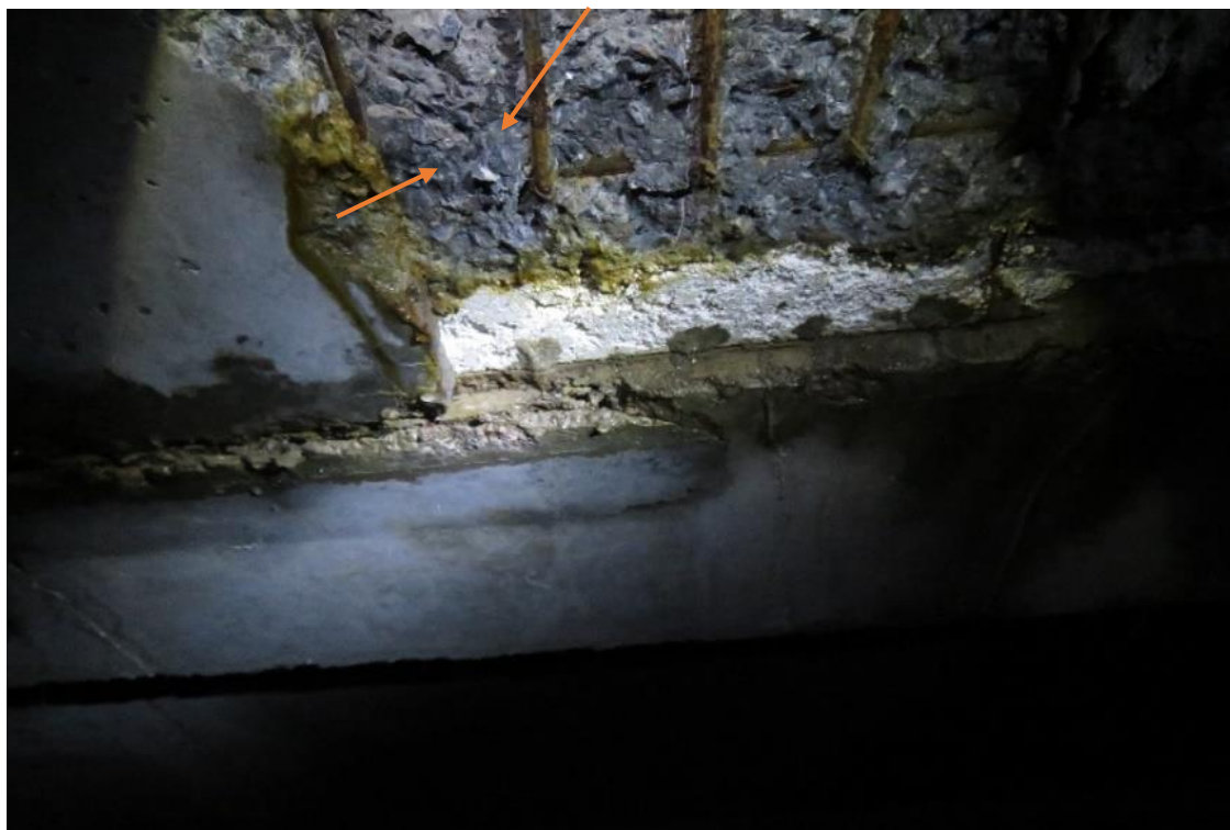
Рис.3. Образование характерных сульфатных высолов на железобетонной конструкции
