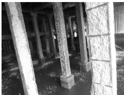
Рис. 1. Разрушение защитного бетонного слоя, оголение и коррозия арматуры железобетонных опорных конструкций площадки градирни в Пермском крае Fig.1. Destruction of the protective concrete layer, exposing and corrosion of reinforcement of reinforced concrete supporting structures of the cooling tower in the Perm region
