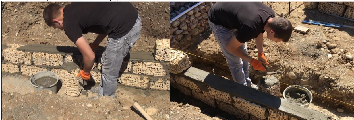
Рис. 3. Пример зафиксированного видеоряда при кладке из известняковых блоков на цементно-песчаном растворе Fig. 3. An example of a fixed footage when laying from limestone blocks on a cement-sand mortar
