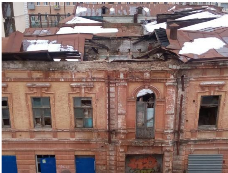
Рис11. Обвалившийся участок крыши здания. 18 января 2019 год.
