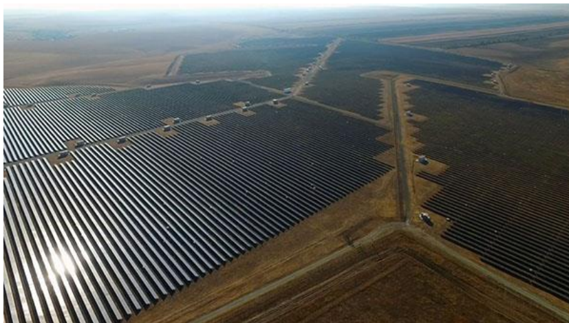
Рис. 7. Солнечная электростанция «Перово» в Крыму на 106 МВт (S=200га).
