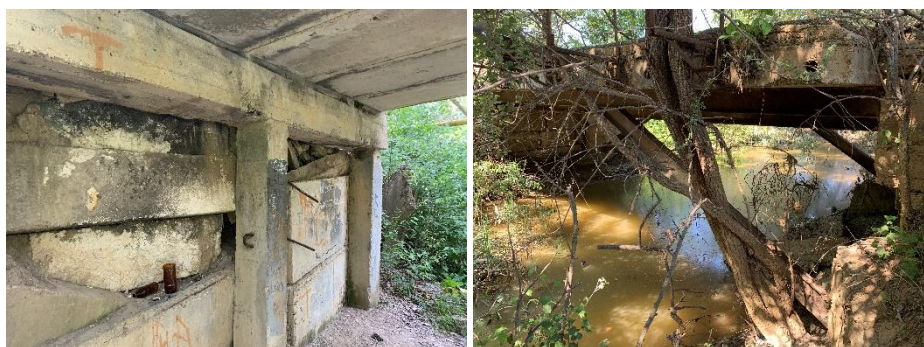
Рис. 5 Неработоспособное состояние мостов через р. Альма Fig. 5 Inoperable condition of bridges across the Alma river
