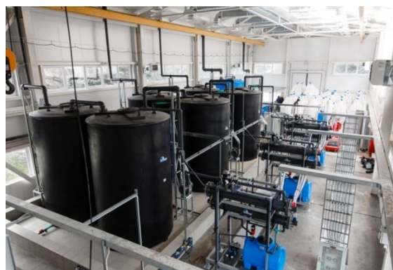
Рис. 2. Электролизная станция производительностью 750 кг/сут по эквиваленту хлора на водоочистных сооружениях «Партизанский гидроузел», г. Симферополь
