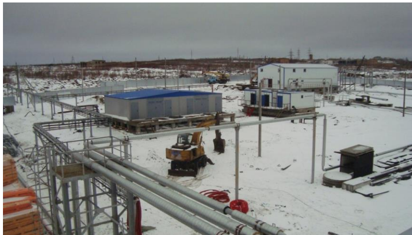
Рис. 4. Комплекс блочно-модульной станции водоподготовки Fig. 4. Complex of block-modular water treatment plant
