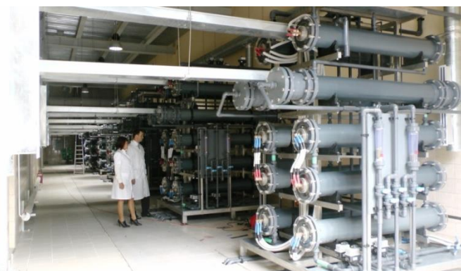
Рис. 1. Электролизная станция на Александровских ОСВ с семью установками «ХЛОРЕФС» производительностью 7 т/сут по эквиваленту хлора для обеззараживания питьевой воды г. Ростова-на-Дону
