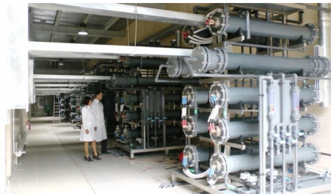
Рис. 1. Электролизная станция на Александровских ОСВ с семью установками «ХЛОРЕФС» производительностью 7 т/сут по эквиваленту хлора для обеззараживания питьевой воды г. Ростова-на-Дону
