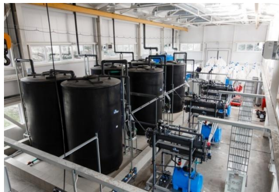
Рис. 2. Электролизная станция производительностью 750 кг/сут по эквиваленту хлора на водоочистных сооружениях «Партизанский гидроузел», г. Симферополь
