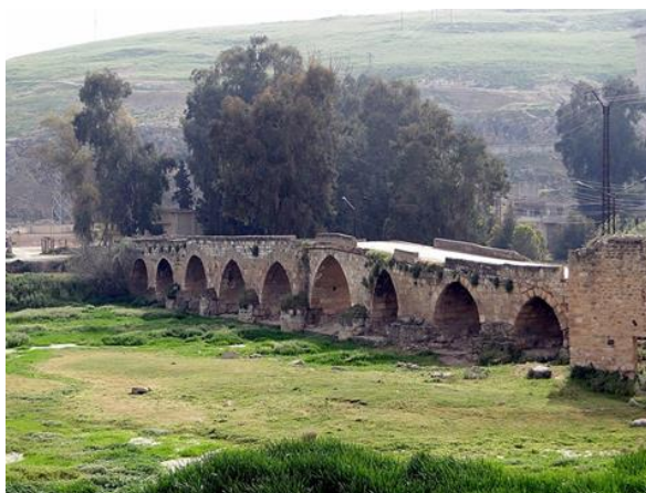
Рис. 1. Древнеримский мост через р. Оронт. Провинция Хама Сирийской Арабской Республики. Возведение сооружения датируется 105-200 г.г. нашей эры. Кладка 10 арок. Повреждения, связанные с нарушениями консолидации каменных кладок.
