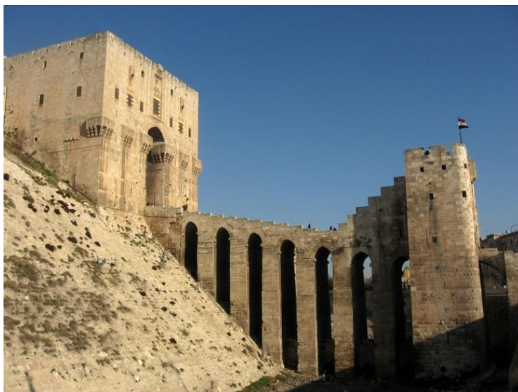
Рис.2. Укрепленный мост, ведущий к цитадели Алеппо. Возведение сооружения датируется 944-957 г.г. нашей эры. Провинция Алеппо Сирийская Арабская Республика. Кладка 7-гранных арок. Повреждения связаны с утратами каменных фрагментов и локальными нарушениями консолидации кладки.
