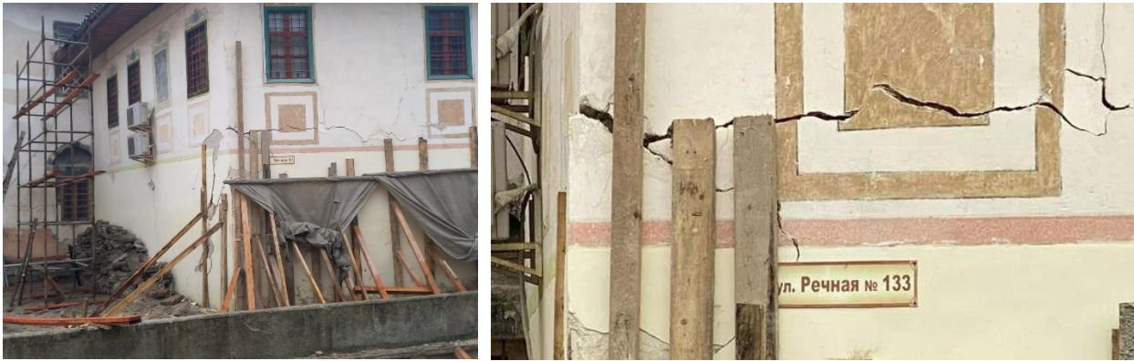
Рис. 12. «Трещина главного фасада Ханского дворца» Fig. 12. «Crack in the main facade of the Khan's Palace»
