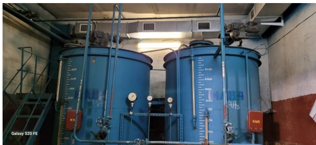
Рис. 1. Аммиачное хозяйство с устаревшей вытяжной системой вентиляции.
